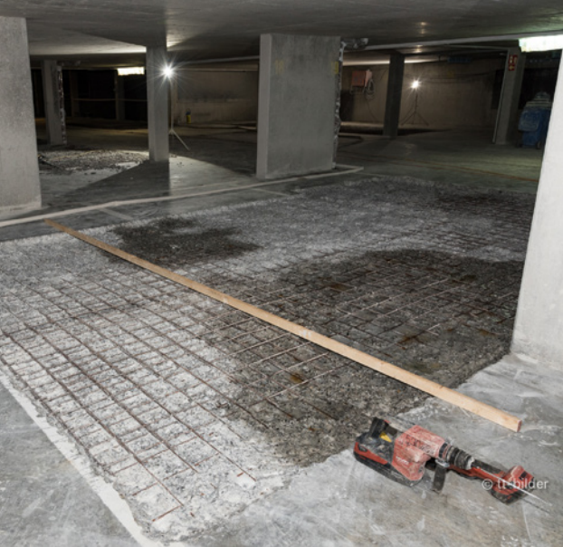
Durch Höchstdruckwasserstrahlen freigelegte Bewehrung
